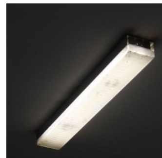
Figura 8.7 – Particolare di un corpo illuminante
